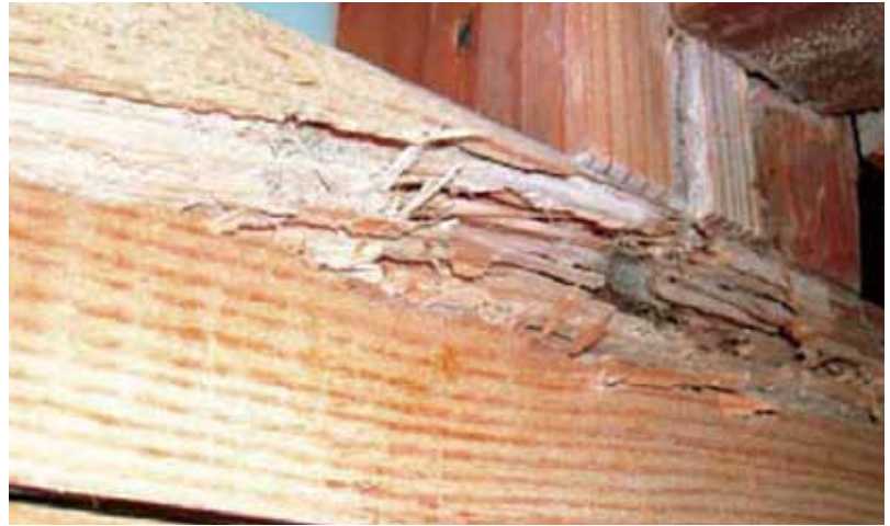
土台部分のシロアリ被害
