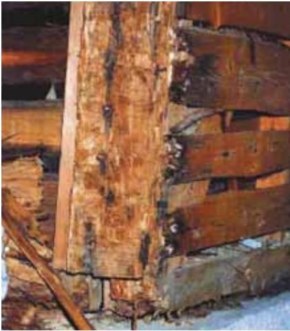
土台と柱部分の劣化(腐れ)
